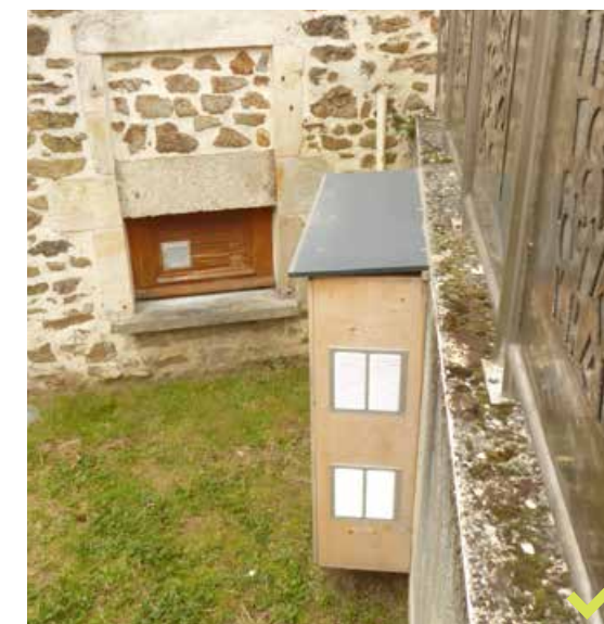
Poste de transformation accompagnant deux toitures photovoltaïques sur des équipements publics : emplacement à l'arrière de la route, dans une sorte de cour arrière peu fréquentée, accolé au mur, alignement à la hauteur du muret, bois, petite toiture en zinc sombre, ventilations placées sur le côté et non en façade... sont autant d'éléments intégrant le dispositif (Chuyer).
